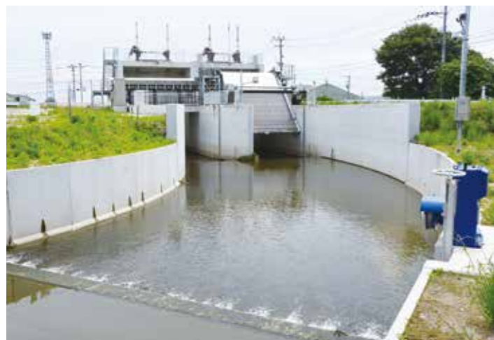
昨年完成した「尼寺排水機場」。2基のポンプを備え、毎秒3トンの排水能力がある
